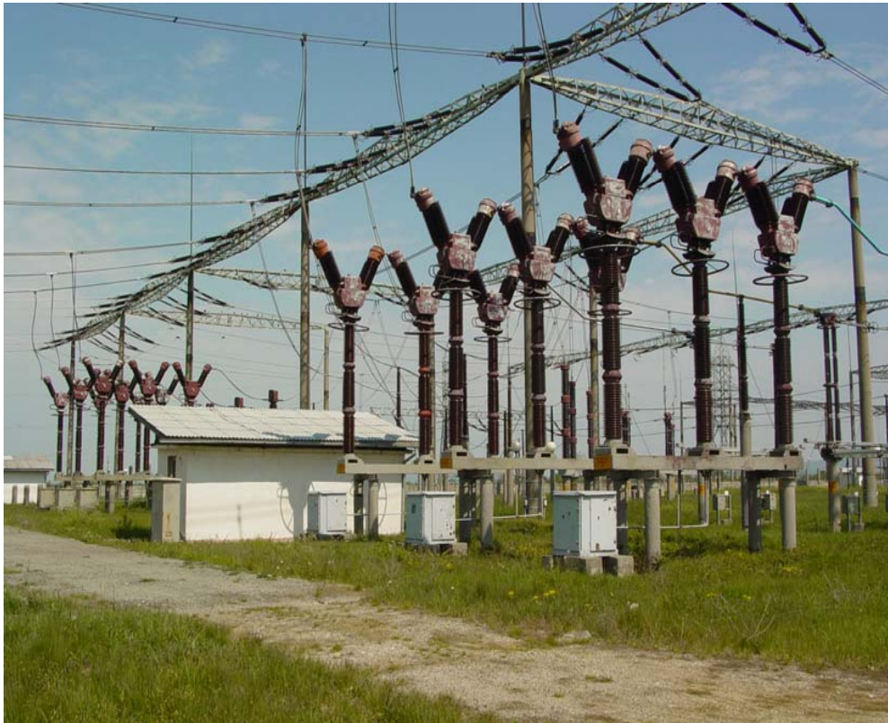
Întreprător 400 kV înainte de retehnologizare
