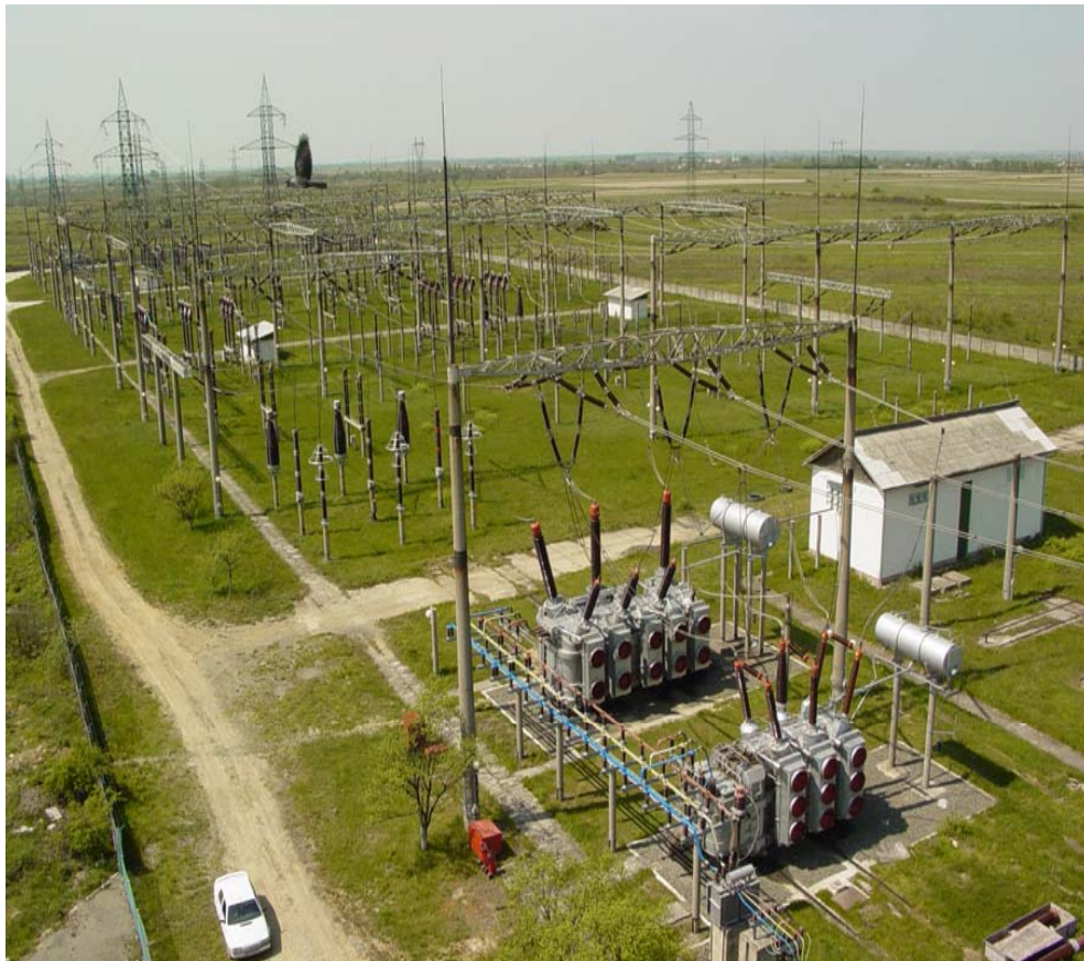
Stația 400 kV înainte de re tehnologizare
