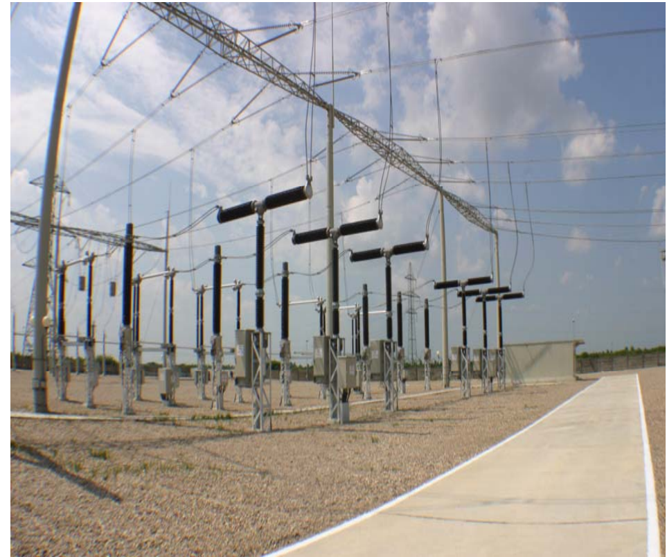
Întreprător 400 kV după retehnologizare
