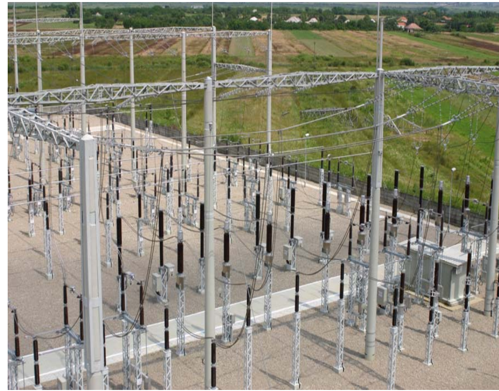
Stația 220 kV după retehnologizare
