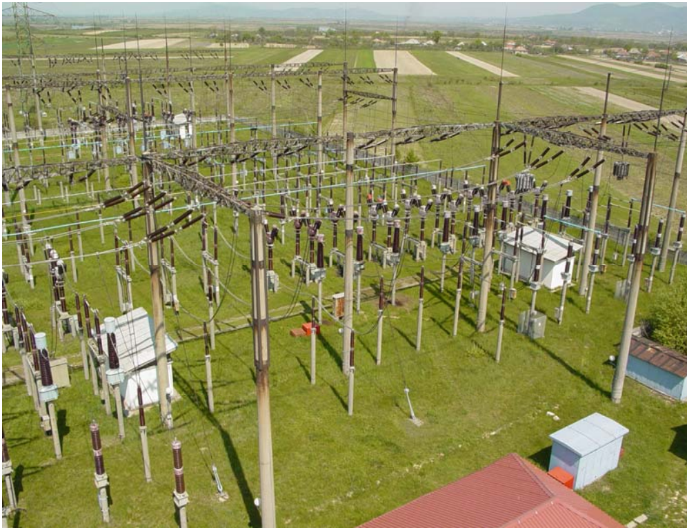
Stația 220 kV înainte de retehnologizare
