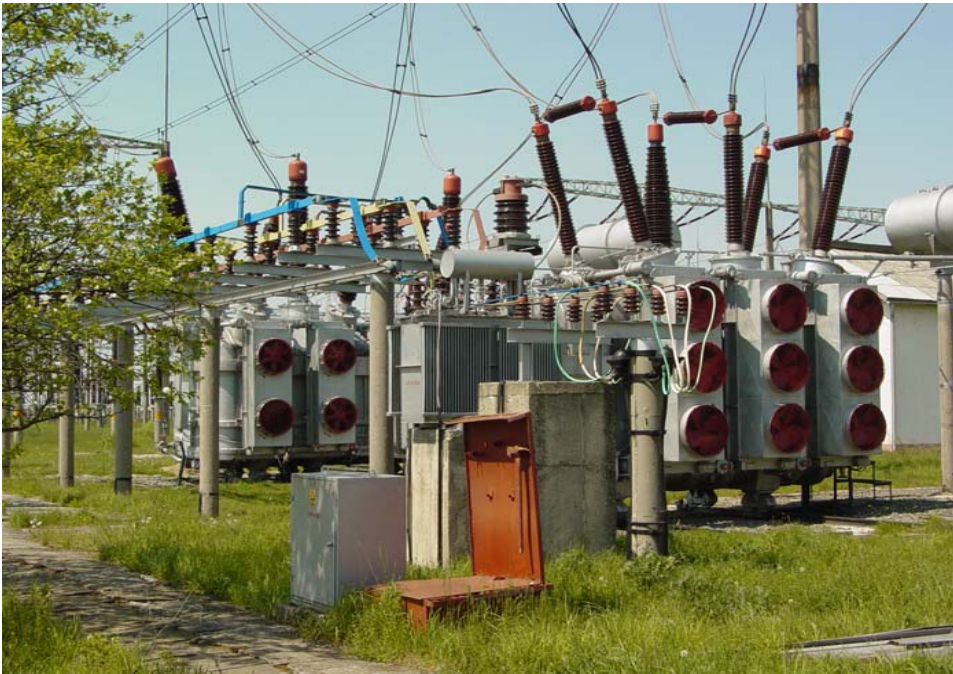
AT 400 MVA înainte de retehnologizare
