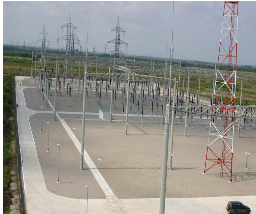
Stația 400 kV după re tehnologizare
